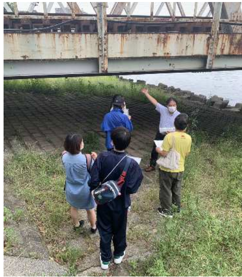
2019年に越水したJR鉄橋部分の多摩川堤防
