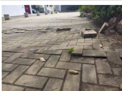
通路がひび割れている渡田新町公園
